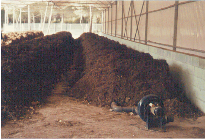
● Equip de ventilació forçada.
